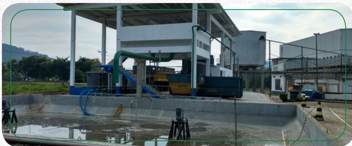
Sistema de tratamento físico químico de efluentes industriais na filial de Presidente Getúlio/SC
