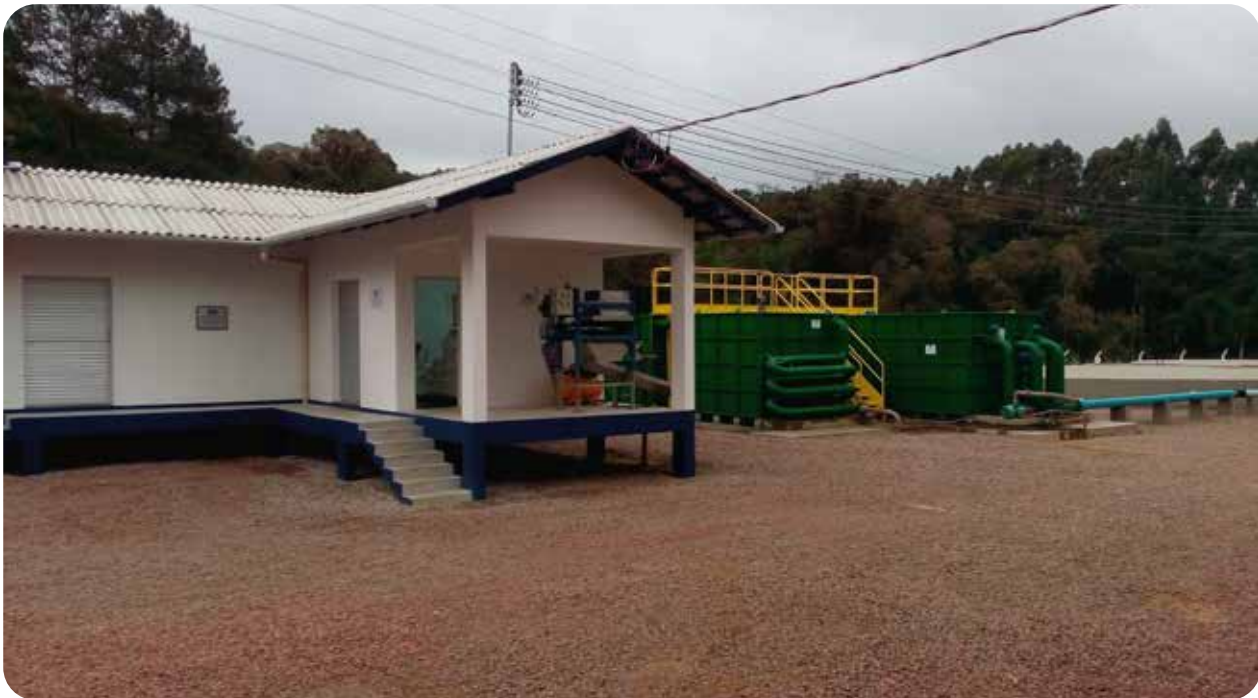
Tratamento de Água
